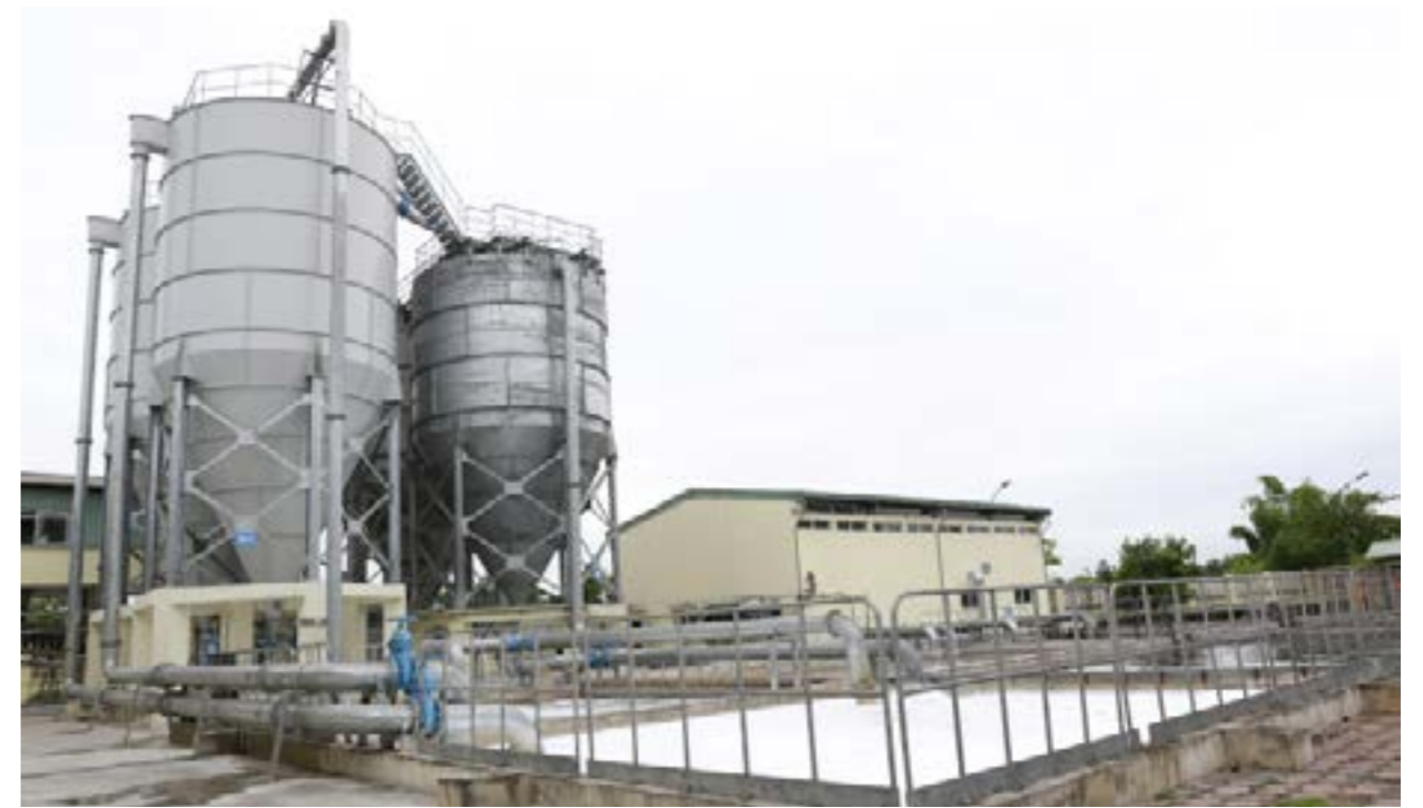
Silo nước tuần hoàn
